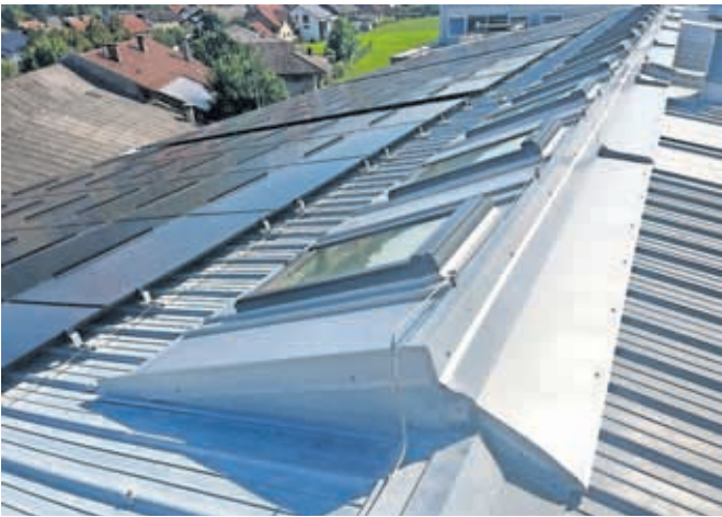
Sončna elektrarna na OŠ Stranje / FOTO: OBČINA KAMNIK
