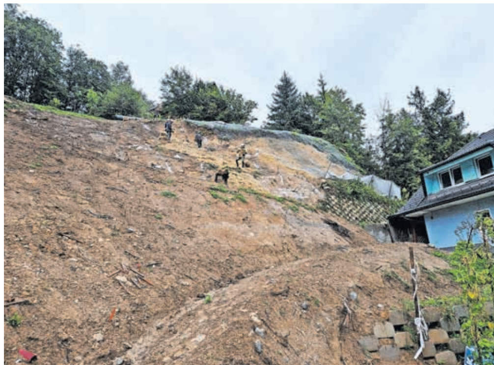
Ena od prioritet poplavne obnove ostaja sanacija plazov. / FOTO: OBČINA KAMNIK
